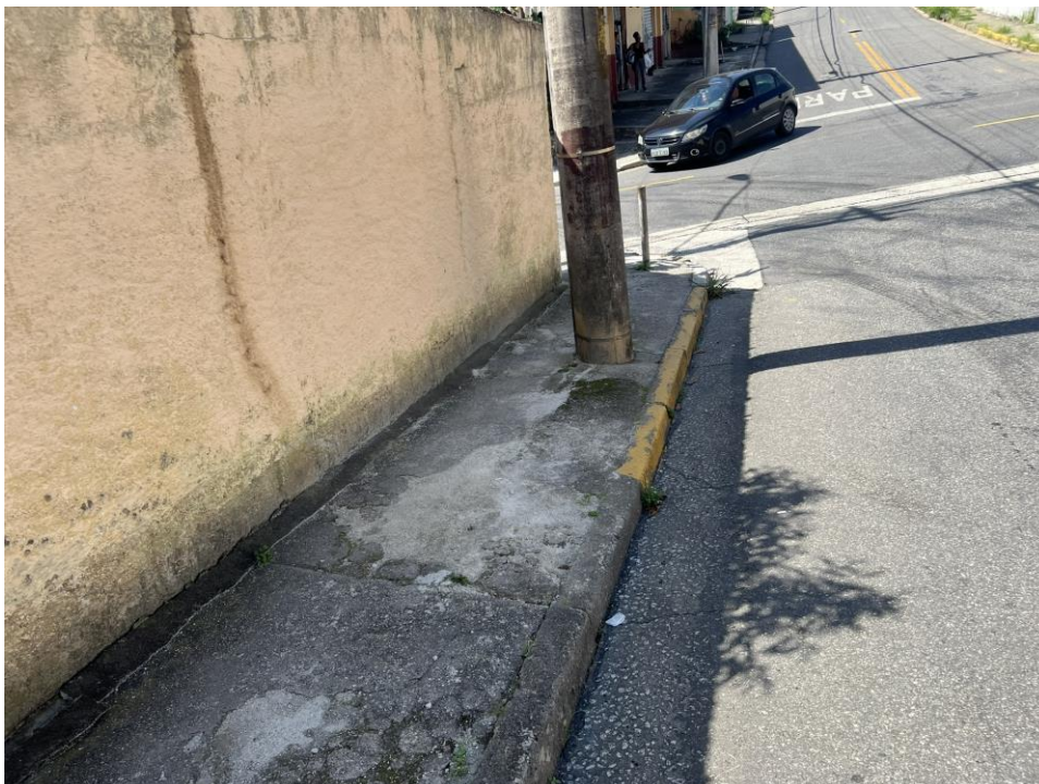
Fotografia 12: Rua Oscar Tompson – Detalhe da calçada
