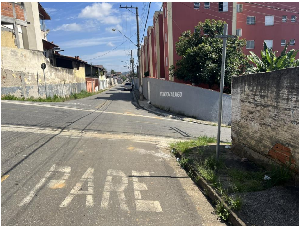
Fotografia 10: Rua Gomes Cardim esquina com Rua Oscar Tompson – Detalhe da falta de plaqueamento e demarcação horizontal apagada.
